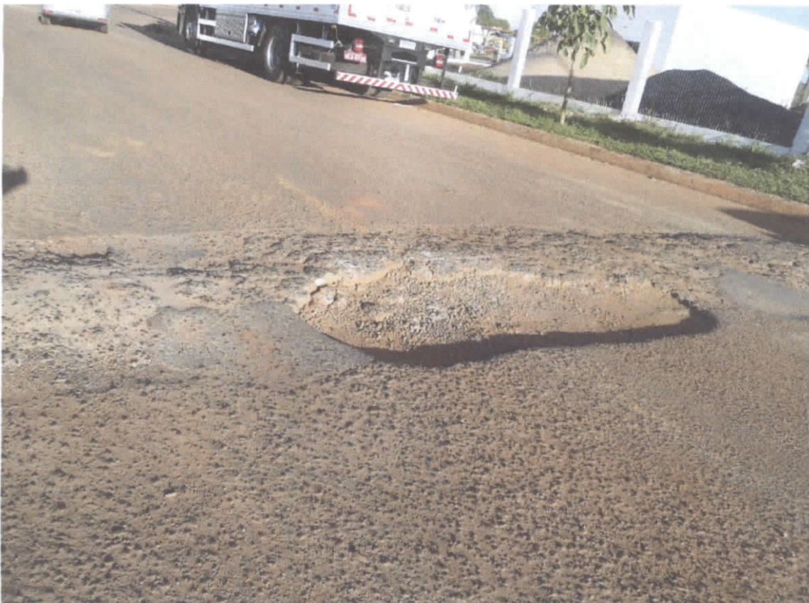
Rua 19 esquina com Avenida Rio da Casca, próximo ao Posto Petrobrás.
